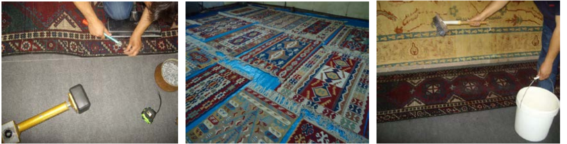
Fotoğraf 27-28-29: Potluk Hatası ve Onarımı
