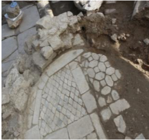
Resim 5: Opus Sectile, Lakuna Oluşumu, Parça Kayıpları ve Derz Bozulmaları
