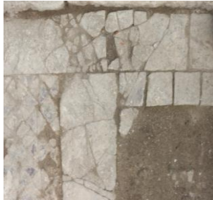
Resim 6: Opus Sectile, Çatlama, Kırılma, Ufalanma ve Yüzeysel Bozulmalar
