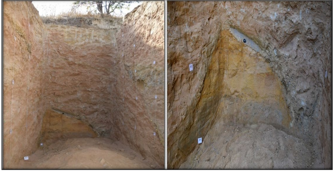
Őekil 5.11: Yeniky hendeęin doęu duvarındaki kayma izikli normal fay ve fay kili.
