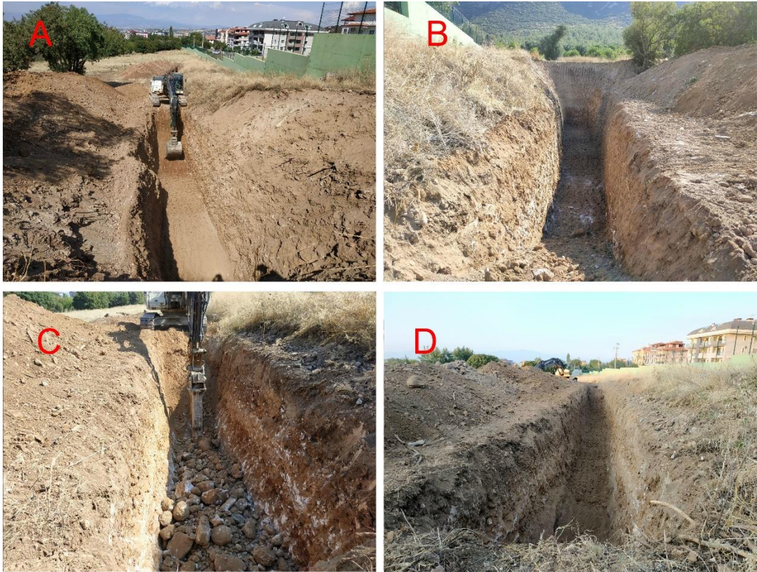
Şekil 5.5: Hendek kazı çalışmaları A ve B) Kozlupınar Hendeği-1, C ve D) Kozlupınar Hendeği-2.
