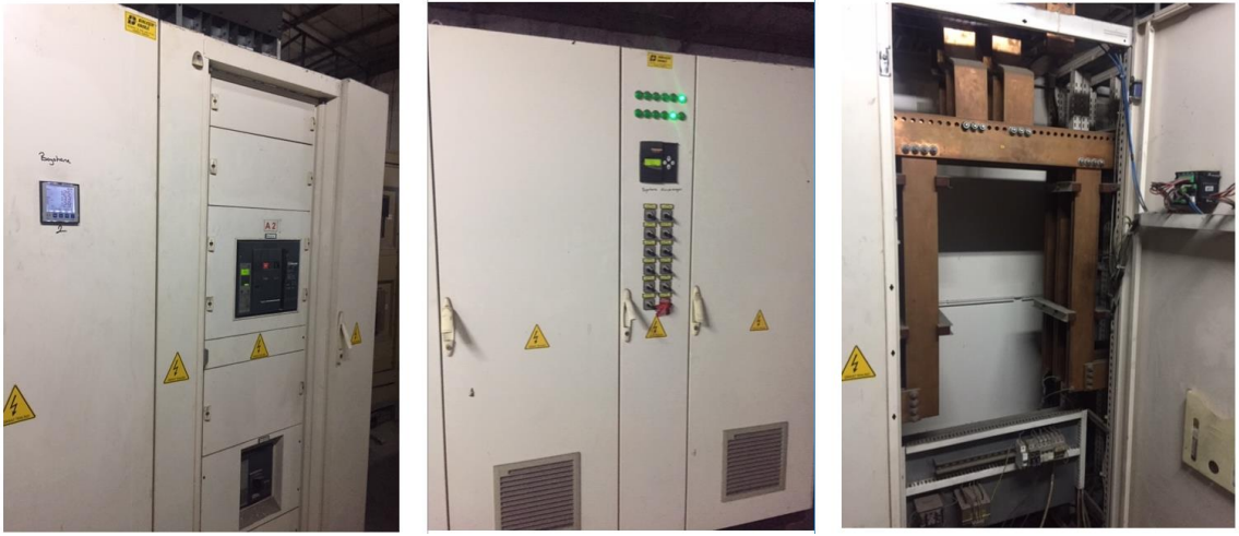
Şekil 5.3: Boyahane ana dağıtım panosu, kompanzasyon panosu ve fider barası
