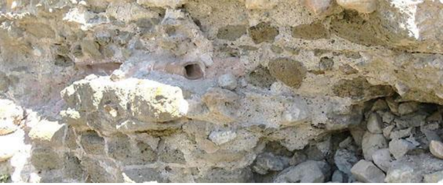
Fotoğraf 5: Kuzey Cephe Duvarı Üzerinde Su Künkleri (M. Kutlu Arşivi, 2018)
