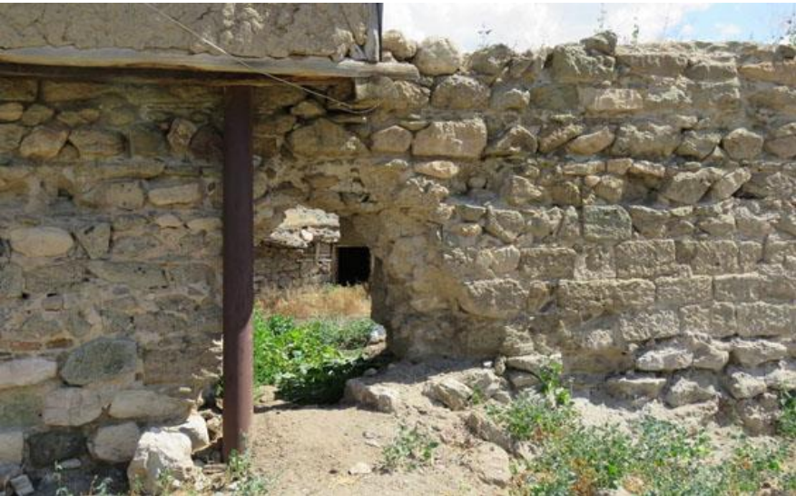
Fotoğraf 6: Kuzey Cephe Duvarındaki Gedik (M. Kutlu Arşivi, 2018)
