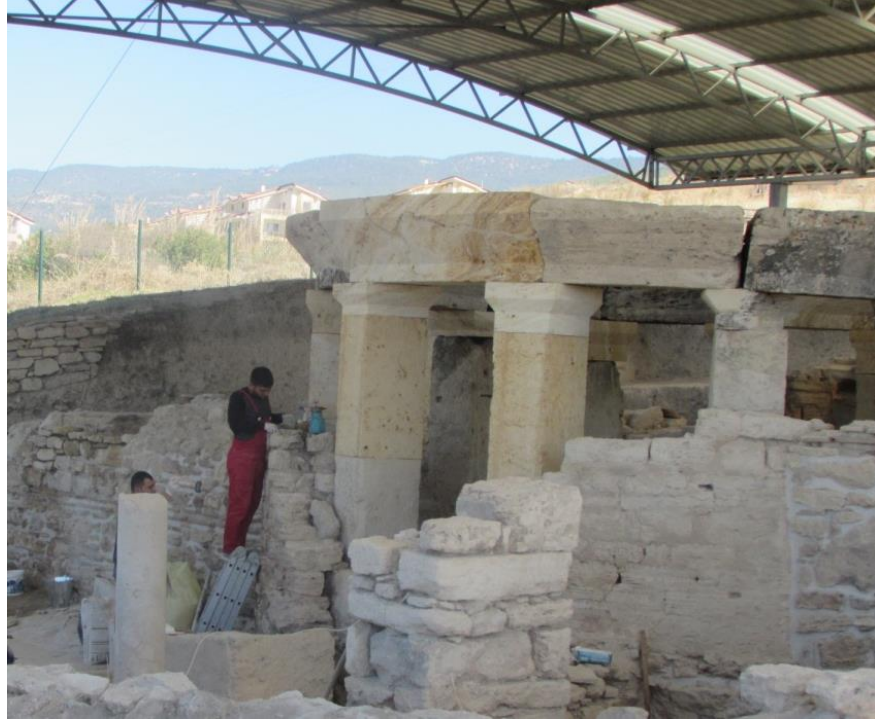
Fig. 85: Payeler Arasında Yer Alan Duvar ve Sivalar
