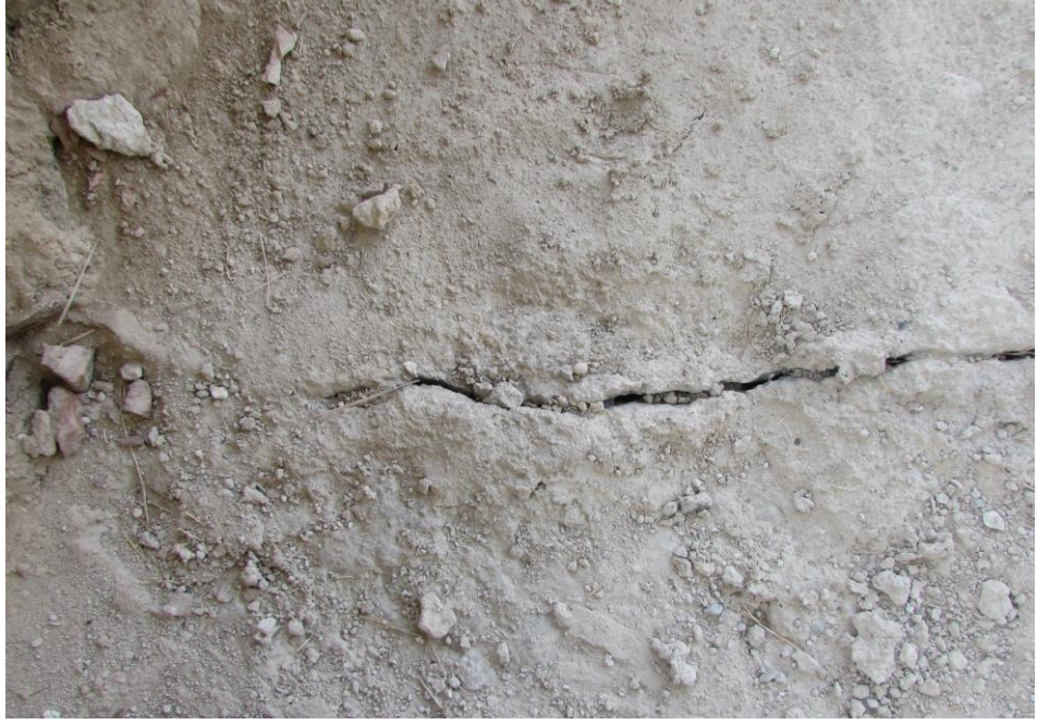
Fig. 134: Hamam Görevlilerine Ait B Bölümünde Tespit Edilen Fay Çatlağı Detay
