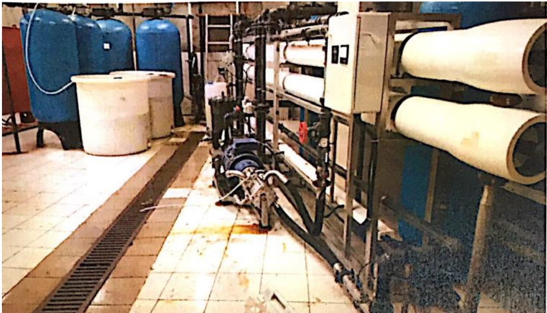
Şekil 5.10: Tesis 3'e ait denizsuyu arıtma tesisi iç görüntüsü
