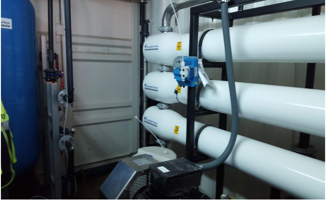
Şekil 5.3: Tesis 1' ait RO arıtma tesisi iç görüntüsü-I
