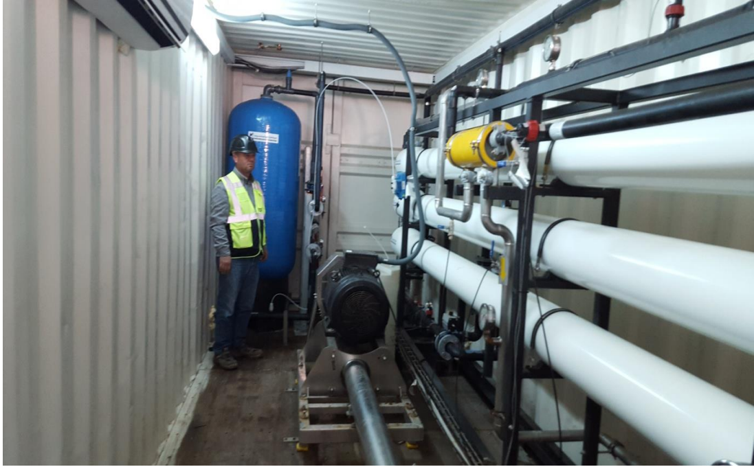
Şekil 5.4: Tesis 1' ait RO arıtma tesisi iç görüntüsü-II
