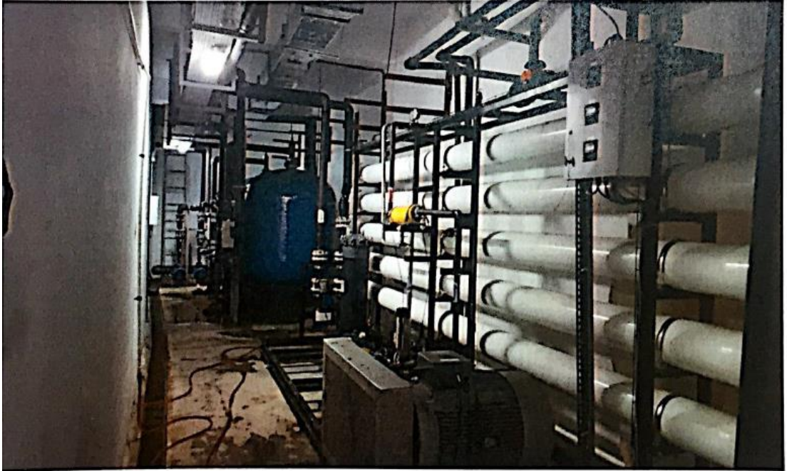
Şekil 5.8: Tesis 2'ye ait deniz suyu arıtma tesisi iç görüntüsü-I
