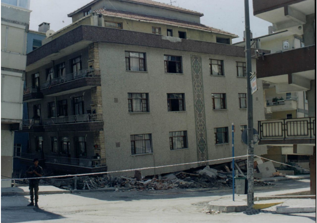
Şekil 2.4: Yumuşak kat sebebiyle zemin katı göçmüş bir bina
