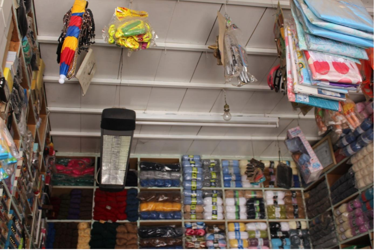
Fotoğraf 77: 12. Dükkan Plastik Malzemeli İç Mekan Tavan Örtüsü (2018).
