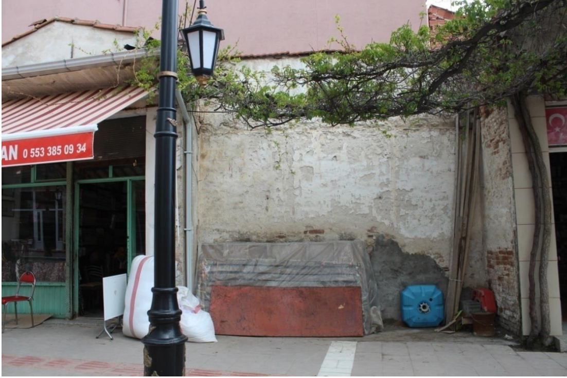
Fotoğraf 83: 13. Dükkan Güney Biriminin Batı Cephesinin Yıkılan Kısmı (2018).
