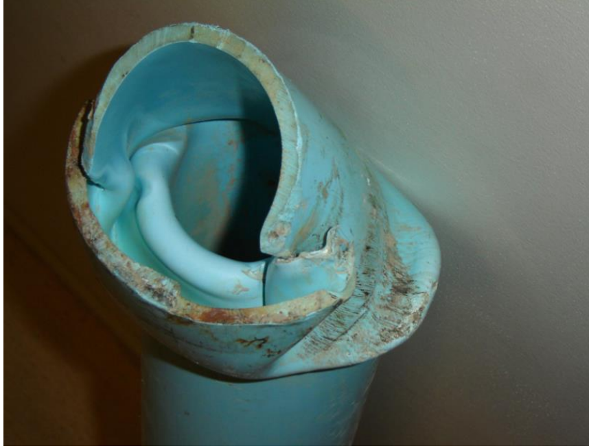
Şekil 3.6: Christchurch depreminin neden olduğu PVC boru hasarı (O'Callaghan 2014)
