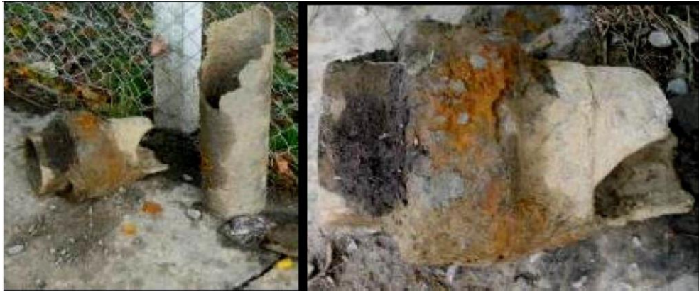
Şekil 3.8: Dökme demir (CI) boru kırılma hasarı (Black, 2013)
