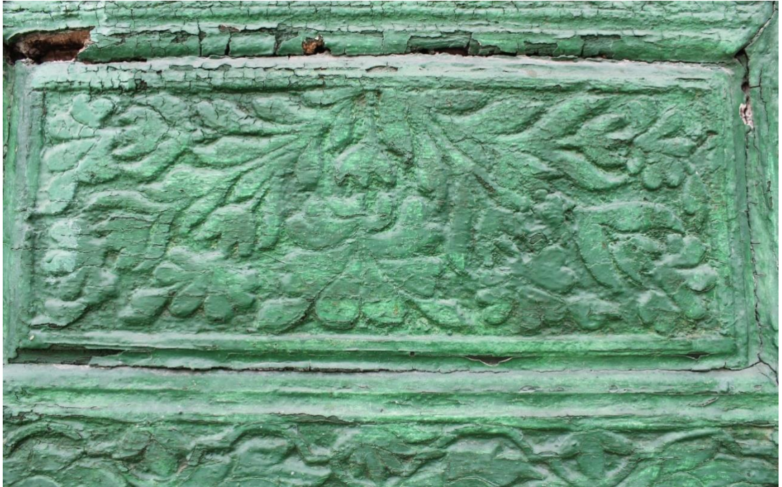
Fot. 265: Yatay Dikdörtgen Panodan Görünüm
