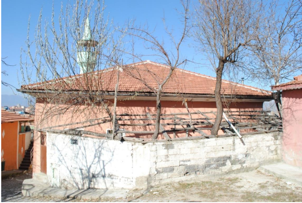
Fot. 204: Caminin Güney Cephesinden Görünüm
