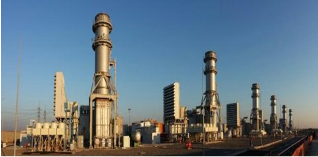
Şekil 6.2: Nainawa Doğalgaz Çevrim Santrali Görünümü (Çalık Holding Arşivi, 2011)
