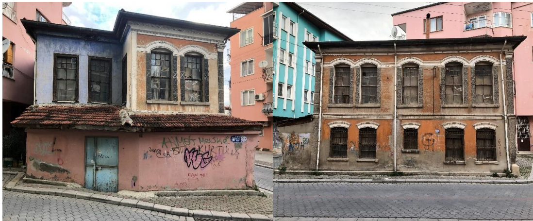
Fotoğraf 4.15. Yıkılmaya Terk Edilmiş ve Zarar Verilmiş Bazı Tarihi Yapılar
