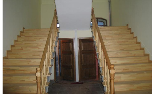
Foto. 494. Bilecik İdâdîsi 2005 Restorasyonu Sonrası Merdivenlerde Meydana Gelen Değişim
