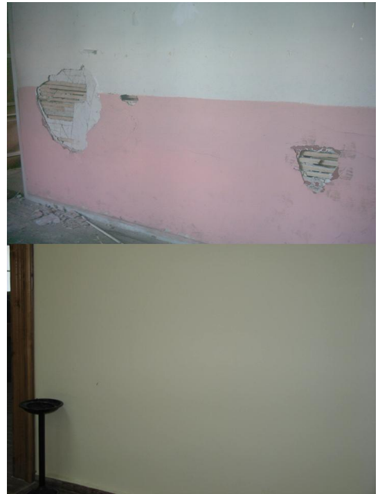
Foto. 492. Bilecik İdâdîsi 2005 Restorasyonu Öncesi İç Sıva ve Boya Durumu
