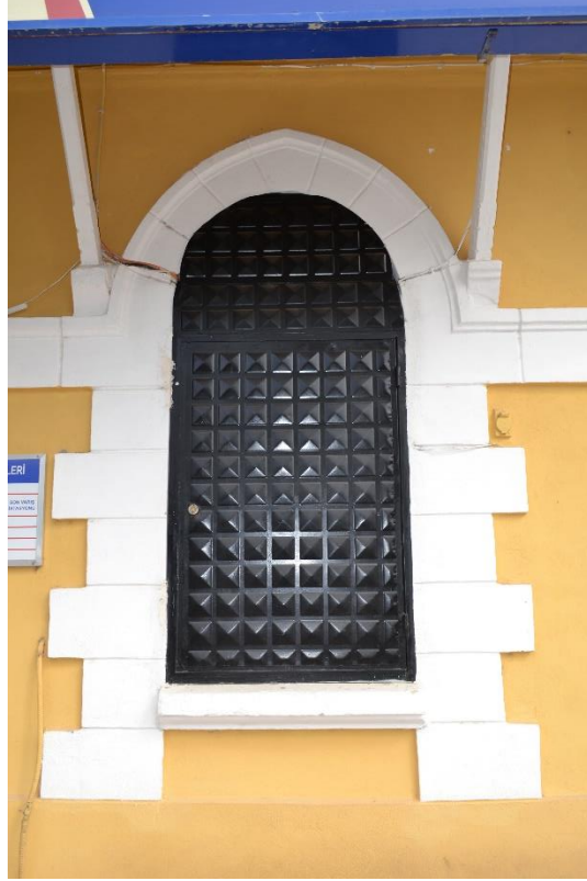
Fotoğraf 85: Köprüören İstasyonu Yolcu Binası Saçak Altı Destekleri ve Silme Kuşağının Birleştiği Yerler (Pencere Örneği).
