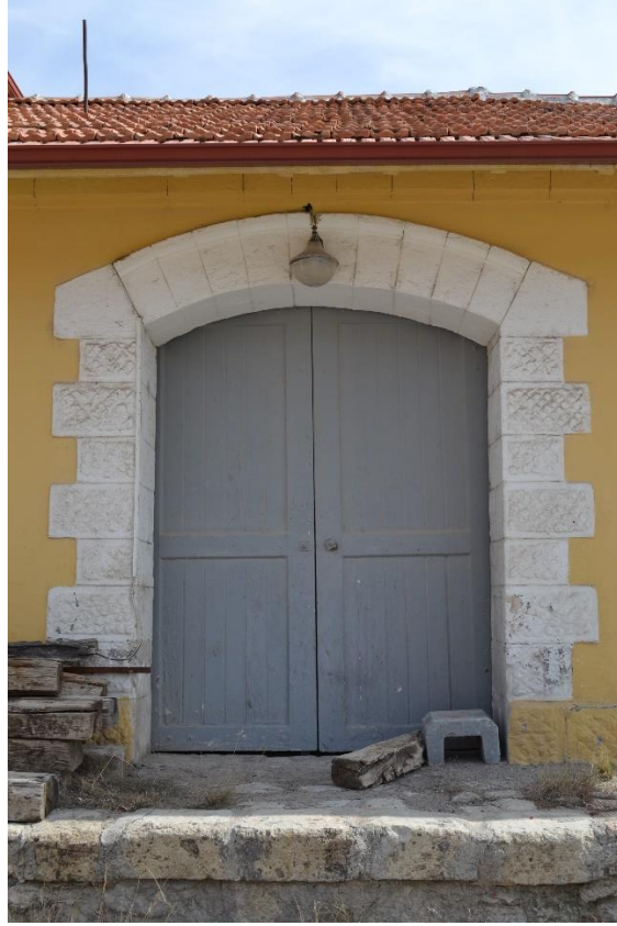
Fotoğraf 73: Emirler İstasyonu Ambar Binası Kapı Örneği.
