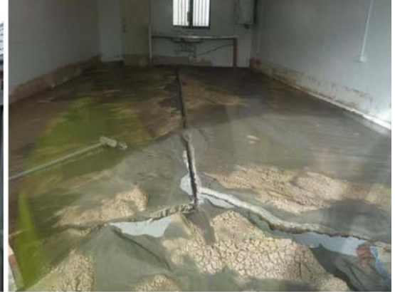
f) Bina tabanında zemin sıvılaşması
