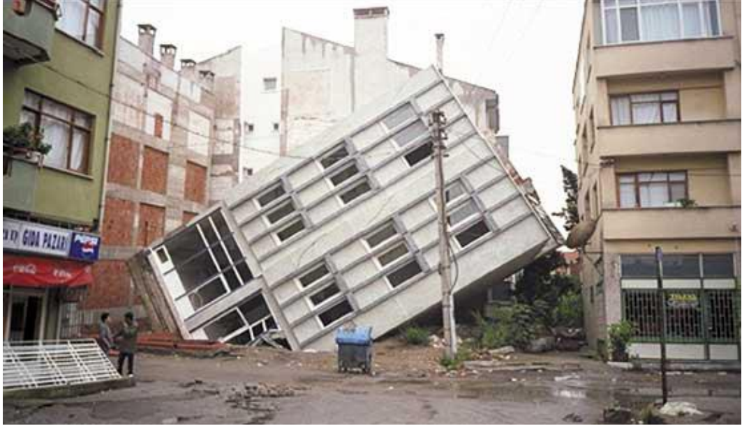
Şekil 2.2: 1999 Kocaeli (İzmit) depremi sırasında Adapazarı, Türkiye. Sıvılaşma etkisi ile hasar görmüş yapı (Manav ve diğ. 2019).
