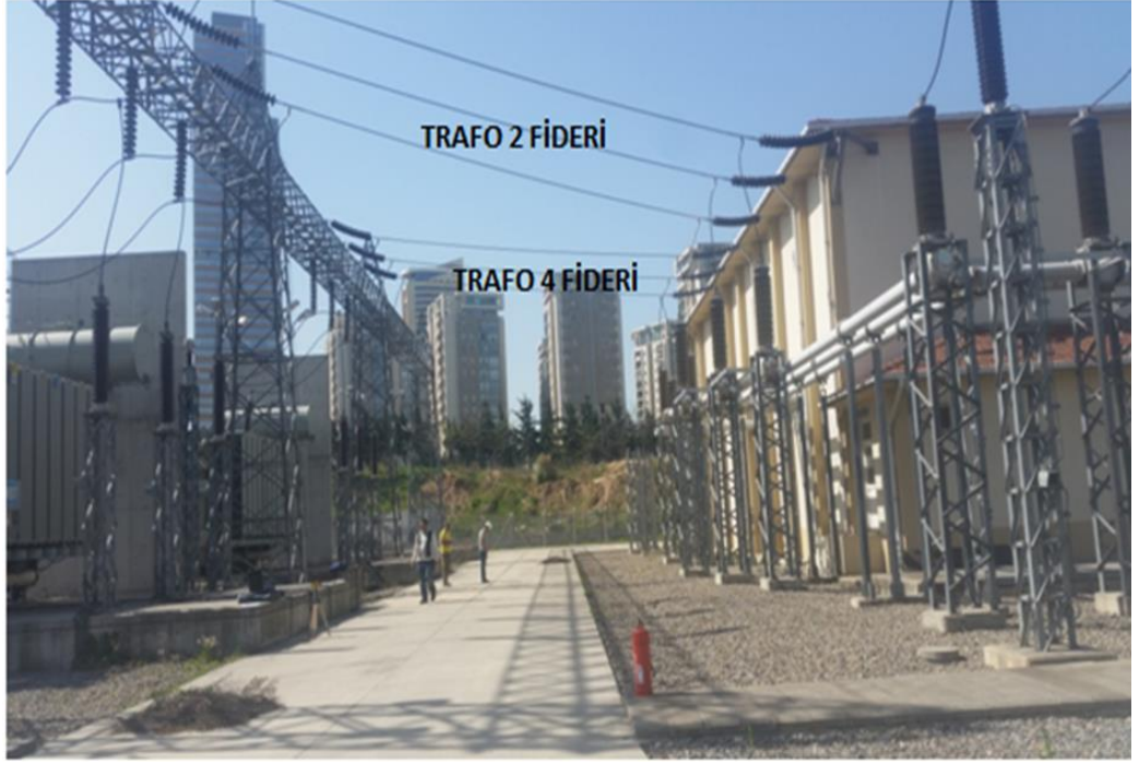
Şekil 4.5: 400 kV Küçükbakkalköy Trafo Merkezi Trafo-2 ve Trafo 4 Fiderleri
