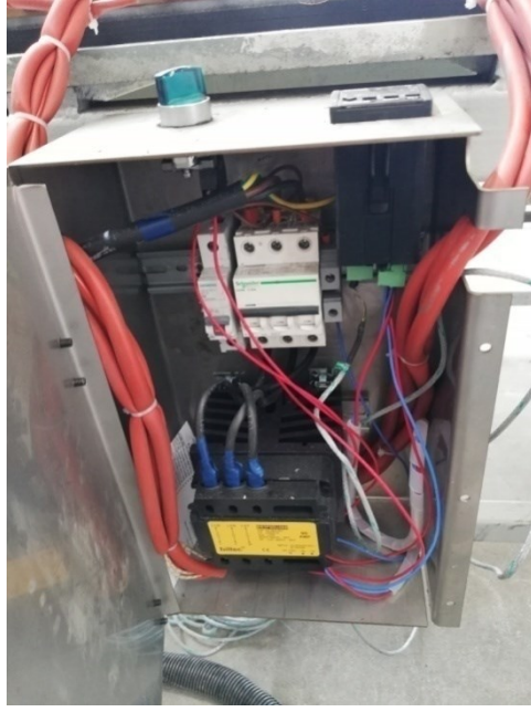
Şekil 3.14 Sıcaklık Kontrol Ünitesi Panosunun İçi
