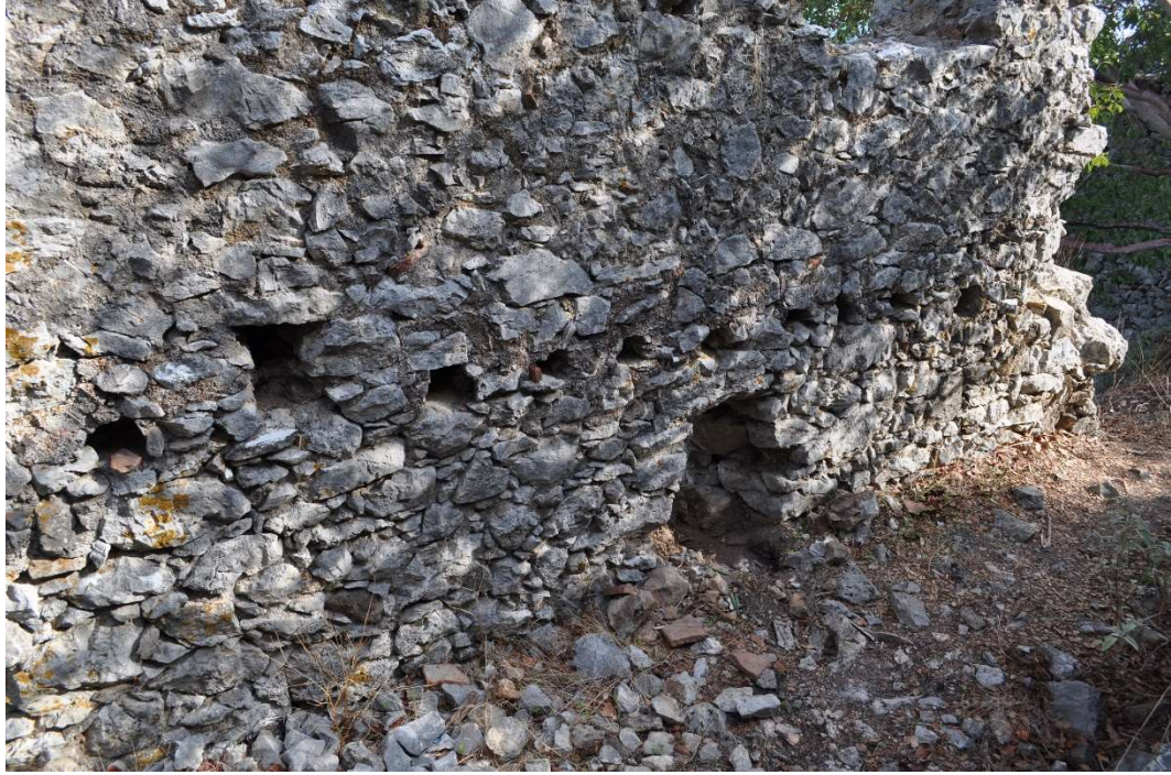
Şekil 80. Kuzey duvarda zemini taşıyan ahşapları giriş izleri
