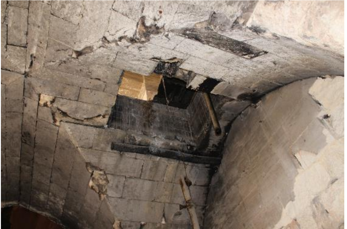
Fotoğraf 599: Nizip Sayınlar Sabunhanesi Çapraz Tonoz Yüzeyindeki Kare Boşluk (M. Çiftyürek)
