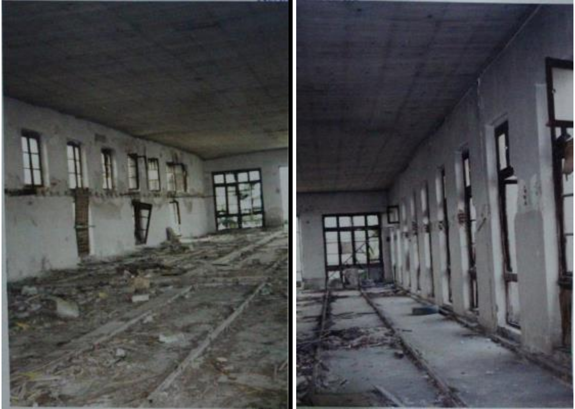
Fotoğraf 97: Ayvalık Erman Sabunhanesi Onarımdan Önce Birinci Kattaki Sabun Kalıpları (Ayvalık Belediyesi Arşivi)
