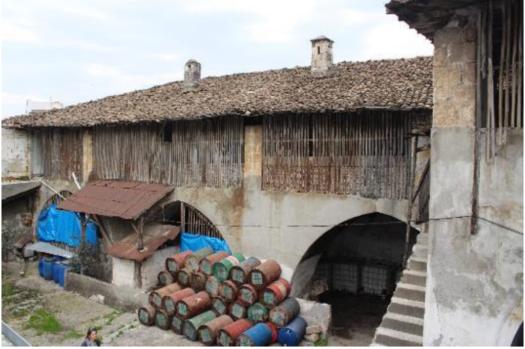
Fotoğraf 452: Antakya Kuseyri Sabunhanesi Batı Cephe ve Çatıdaki Taş Bacalar (M. Çiftyürek)
