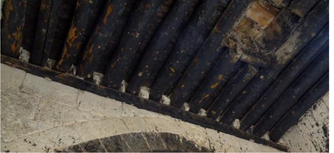
Fotoğraf 863: Birecik Akçakanat Sabunhanesi Zemin Kat Döşemedeki Kare Boşluk (M. Çiftyürek)
