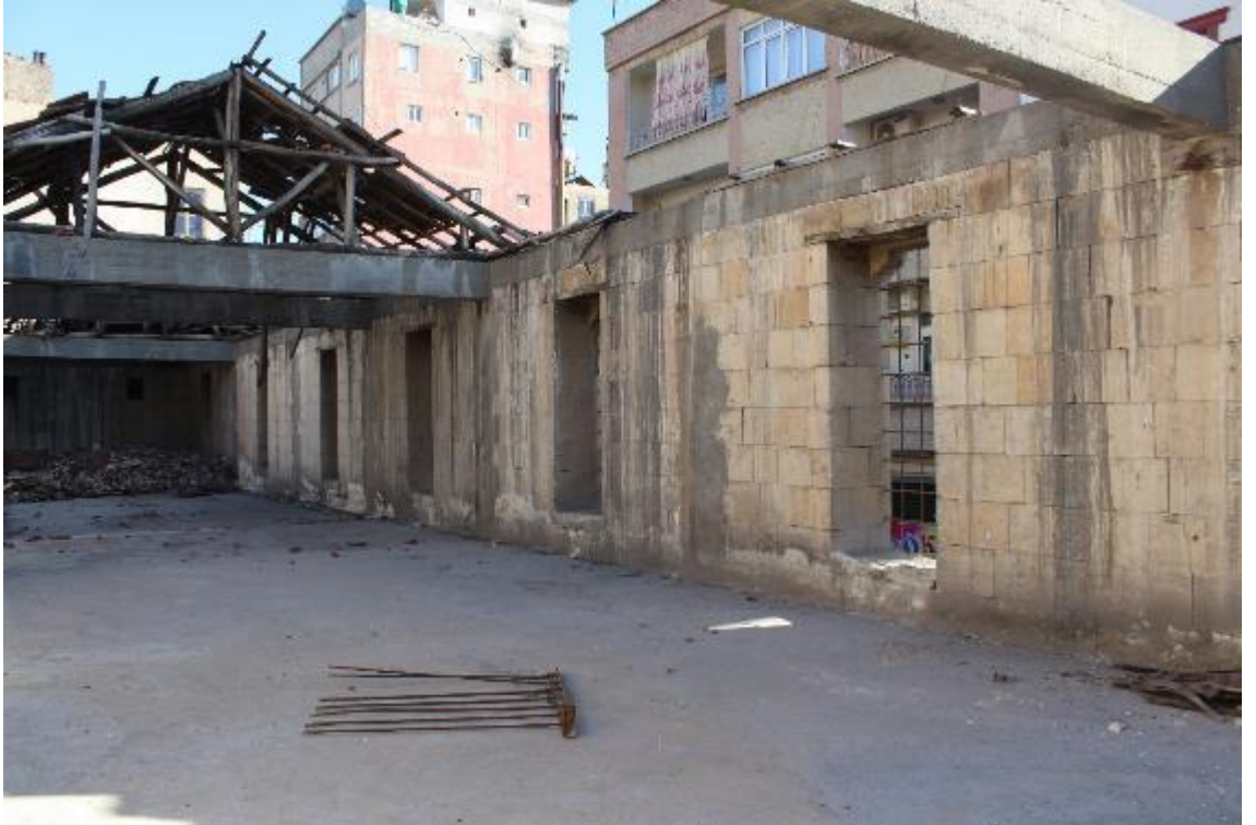
Fotoğraf 689: Nizip Fındıklar Sabunhanesi Güney Bölüm Birinci Katın Güney Duvarı (M. Çiftyürek)
