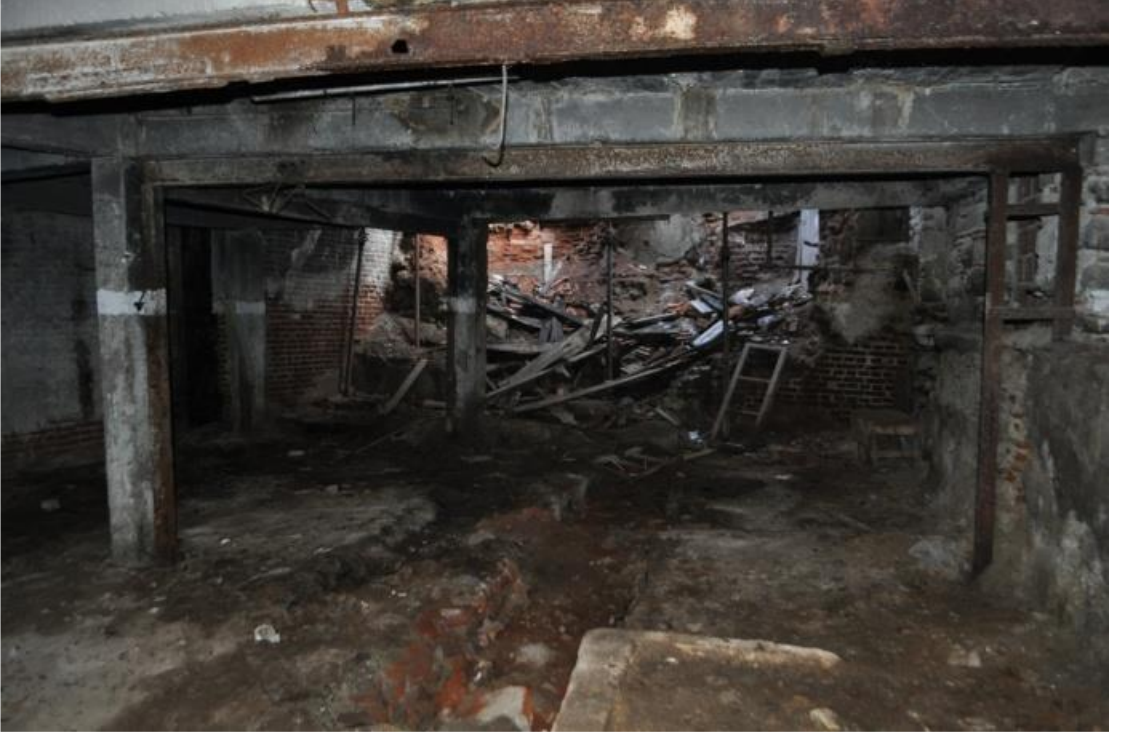
Fotoğraf 279: Konak Hamdi Dalan Sabunhanesi Zemin Katın Güney, Doğu ve Batı Duvarı ve Zemindeki Kanallar, 2015 (Konak Belediyesi Arşivi)
