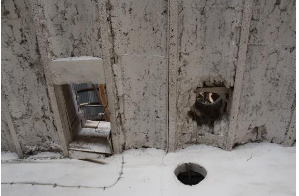
Fotoğraf 649: Kilis Muharrem Bey Sabunhanesi Volta Döşemedeki Boşluk (M. Çiftyürek)
