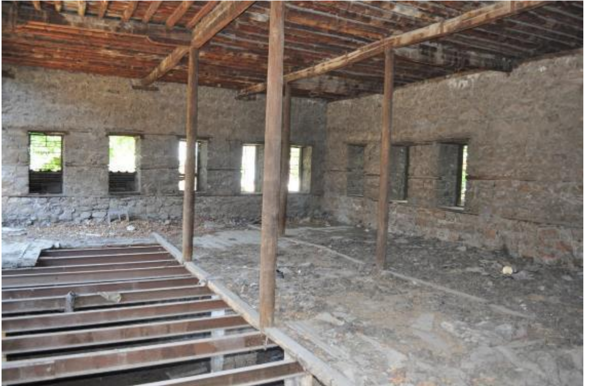
Fotoğraf 803: Kahramanmaraş Cumhuriyet Hanı Sabunhanesi Batı Kütle Birinci Katın Kuzey ve Batı Duvarı, 2011 (Kahramanmaraş Belediyesi Arşivi)
