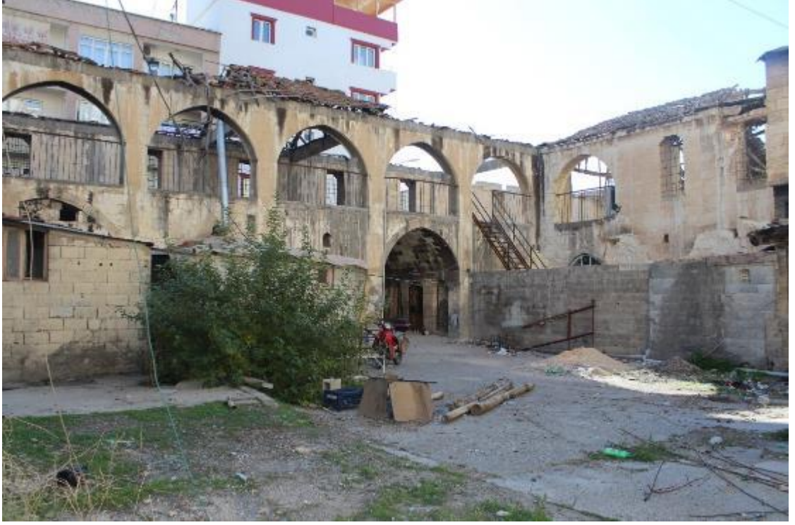
Fotoğraf 668: Nizip Fındıklar Sabunhanesi Avluya Bakan Güney ve Batı Cephe (M. Çiftyürek)
