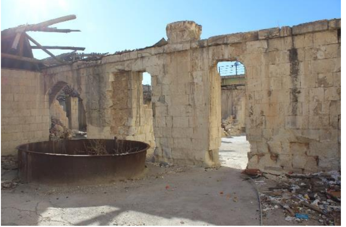
Fotoğraf 682: Nizip Fındıklar Sabunhanesi Birinci Katta Sabun Kazanı (M. Çiftyürek)
