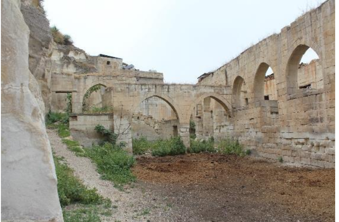
Fotođraf 581: Birecik Mıstıkođlu Sabunhanesi Avluya Bakan Gney ve Batı Cephe (M. iftiyerek)
