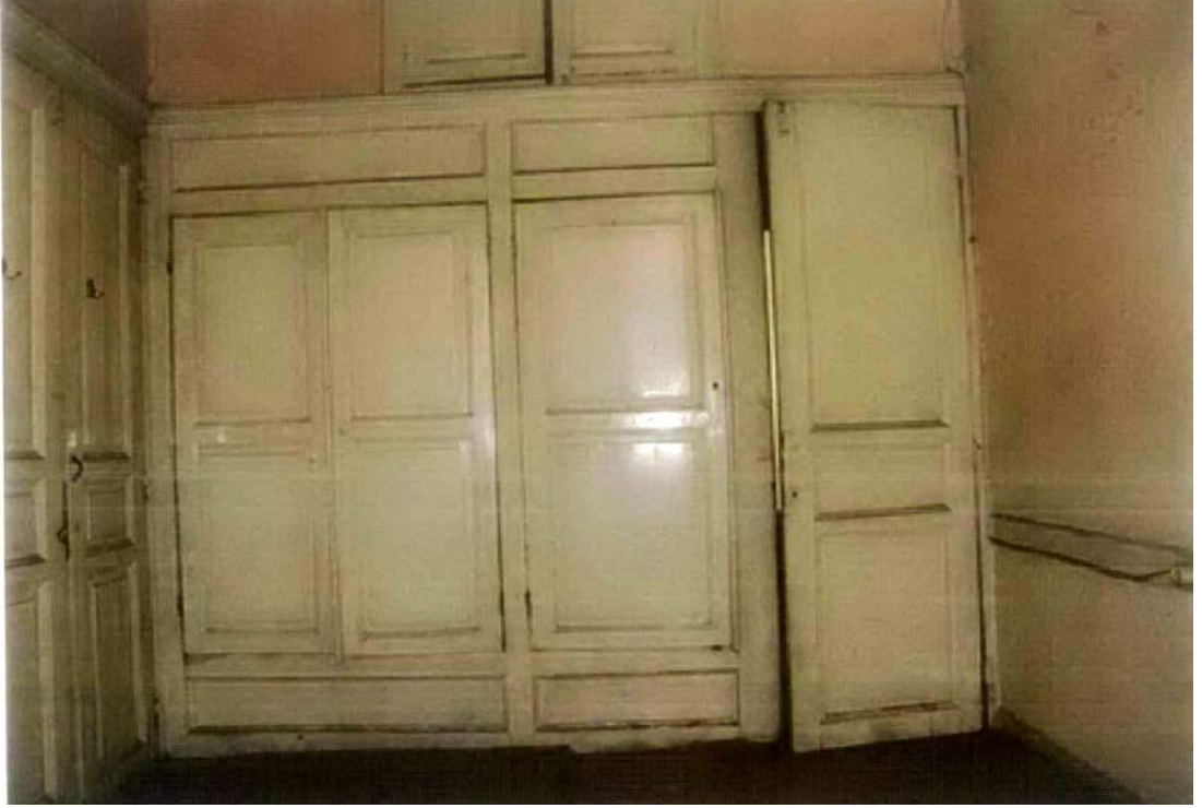
Foto. 526: Musa Arslan Evi Birinci Kat Onarım Öncesi Yüklük (SKVKBK 2012)
