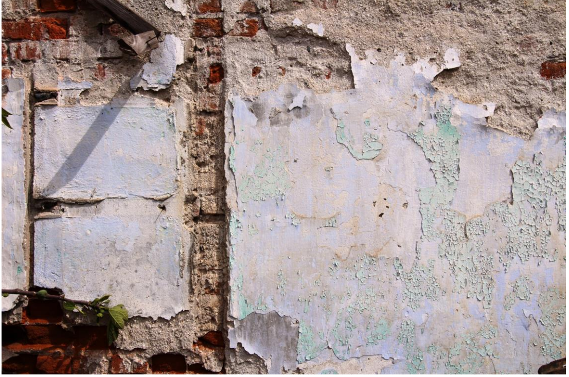
Foto. 116: Mustafa Sandıkçı Evi Zemin Kat Duvar İzleri
