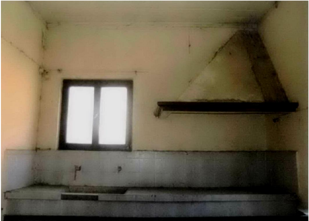
Foto. 65: Ahmet Özder-1 Evi'nin İkinci Kat Mutfağındaki Ocak (SKVKBK 2009)
