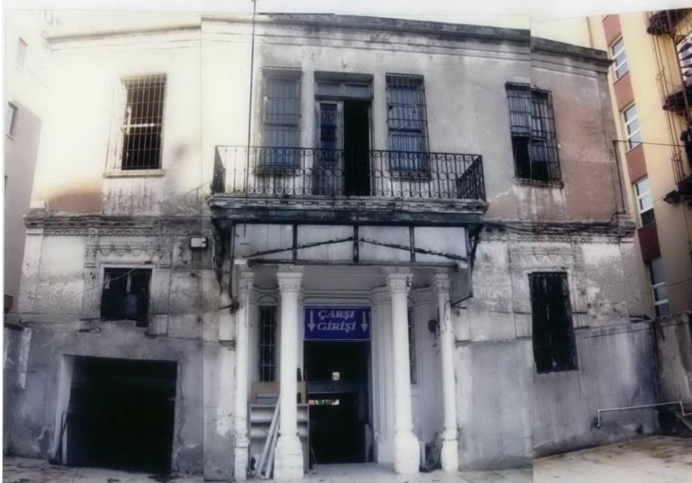
Foto. 334: Batı Cephe Onarım Öncesi Görünümü (SKVKBK 2009)
