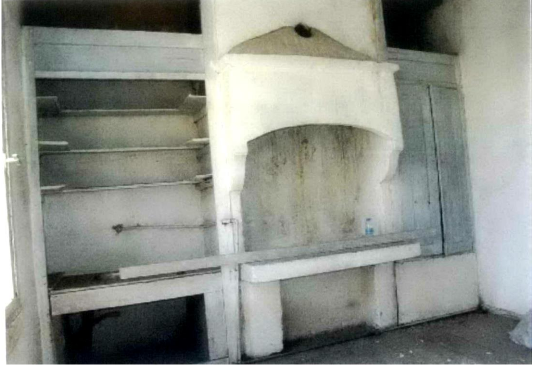
Foto. 75: Ahmet Özder-2 Evi'nin İkinci Kat Mutfağındaki Ocak (SKVKBK 2009)
