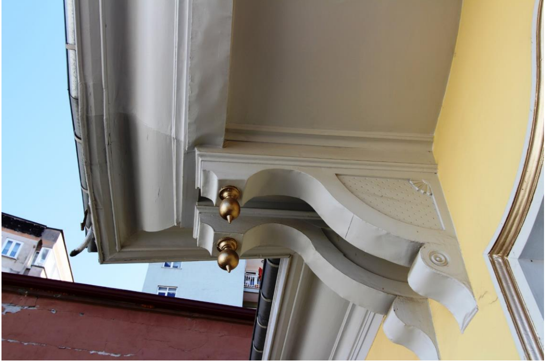
Foto. 464: Fuat Susuz Evi Doğu Cephe Balkon Korkuluğu
