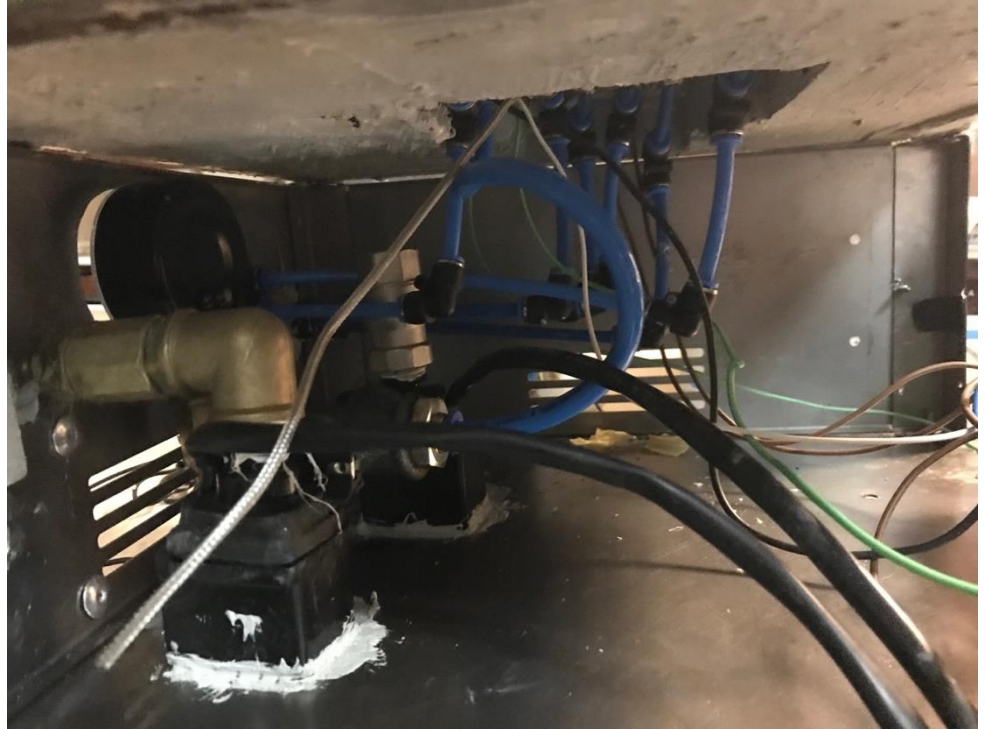
Şekil 4.12: Tesisat müdahale kısmı gerçek görüntü
