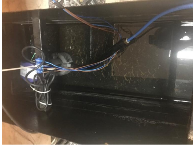
Şekil 4.29: Soğutma Suyu Devir Daim Sistemi
