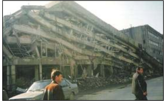
Şekil 1. 17.8.1999 Kocaeli depreminde yıkılan Bolu Deftardarlık binası.
