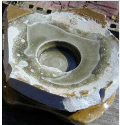
Şekil 8. Alt kısmı hasara uğramış bir porselen izolatör
