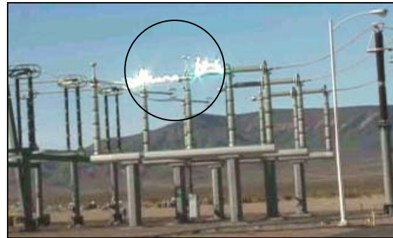
Şekil 5. Bir yük tevzi merkezindeki izolasyon problemi
