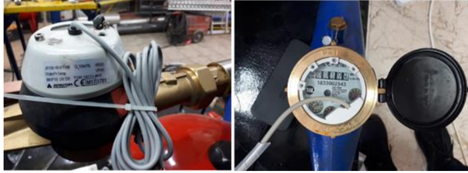
Şekil 3.53: Sıcak su (solda) ve soğuk su (sağda) sayaçları.
