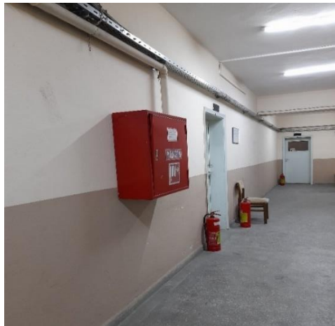
Fig. 148: Bodrum Kat Yangın Dolabı ve Yangın Tüpleri (KYEBM Arşivi)
