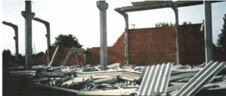
Şekil 1. Prefabrik betonarme endüstri yapılarında gözlenen hasarlar (Observed seismic damages to precast concrete industrial structures)
