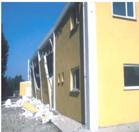
Şekil 2. Rijit diyafram yokluğunda oluşan deprem hasarı (Earthquake damage due to lack of a rigid diaphragm)
