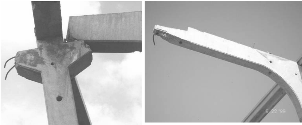
Şekil 6. Birleşim bölgesinde kesme sebebiyle hasar gören binalardan görüntüler
