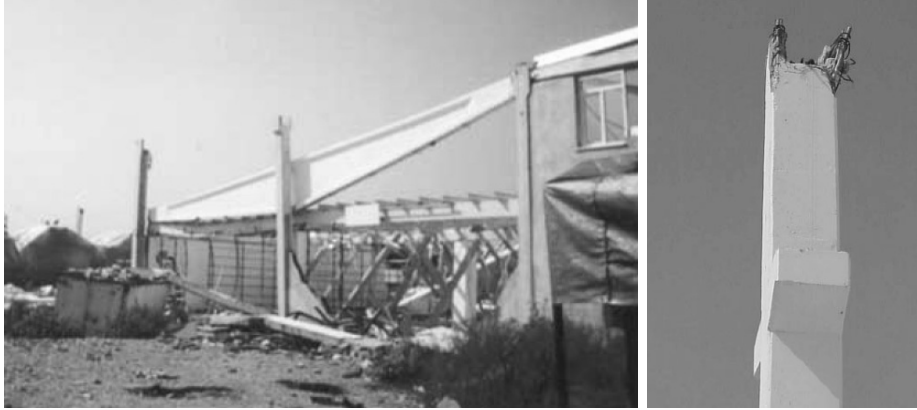
Şekil 10. Makasın birleşim bölgesi etrafında dönmesi sonucu hasar gören binaların resimleri
