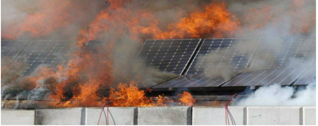
Şekil 3.2: Hatalı montaj sonucu yanan paneller (Enerjibes, 2017)
