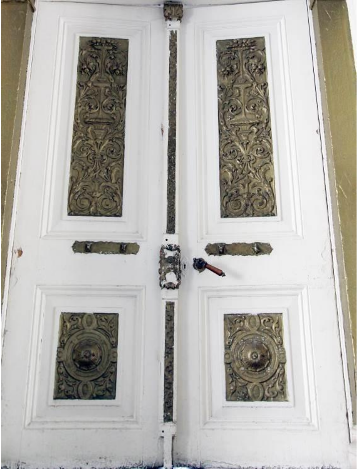
Fotoğraf 375: İzmir Gureba-i Müslimin Hastanesi, Üçüncü Bloğun Kuzey Cephesinin Ortasındaki Kapı Açıklığının Ahşap Kanatları
