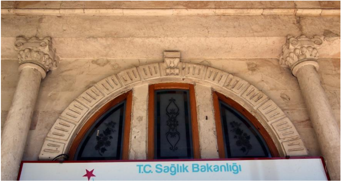
Fotoğraf 596: Urfa Hamidiye Hastanesi, Ana Kapı Açıklığı Kemerli ile Kapının İki Yanındaki Sütunlardan Detay
