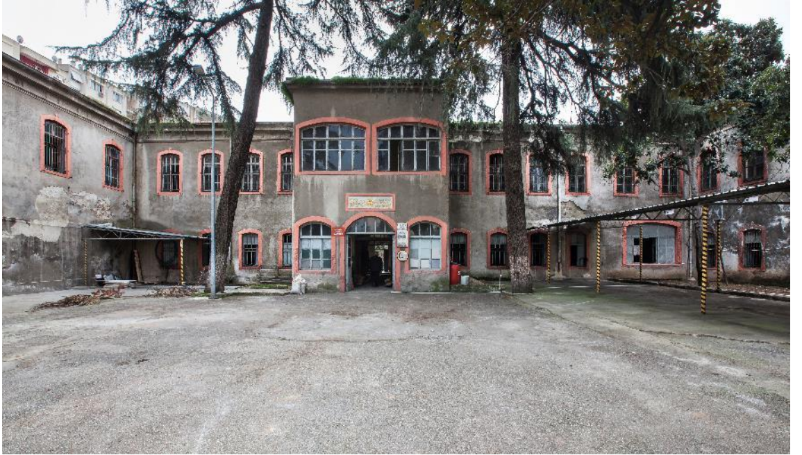
Fotoğraf 303: İzmir Hamidiye Askeri Hastanesi, Orta Bloğun Avluya Bakan Cephesinin Restorasyon Öncesindeki Hali (İzmir Kâtip Çelebi Üniversitesi Arşivinden)
