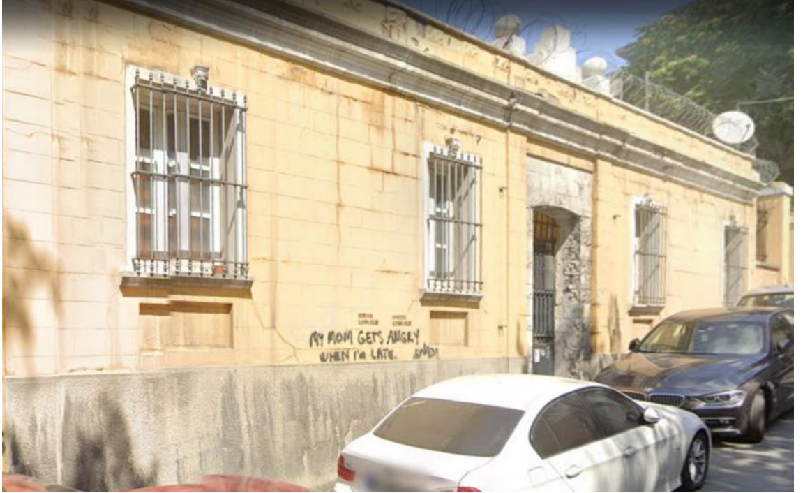
Fotoğraf 161: İtalyan Hastanesi, Konferans Salonu ve Güvenlik Binası Doğu Cephesi (Google Earth)
