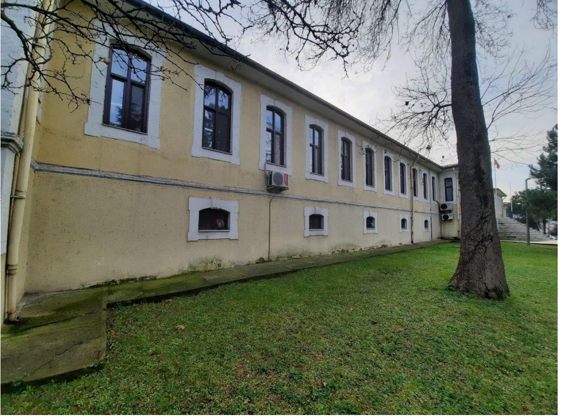
Fotoğraf 138: Trabzon Hamidiye Asker ve Gureba Hastanesi Kuzey Kanadın Dışa Bakan Cephesi
