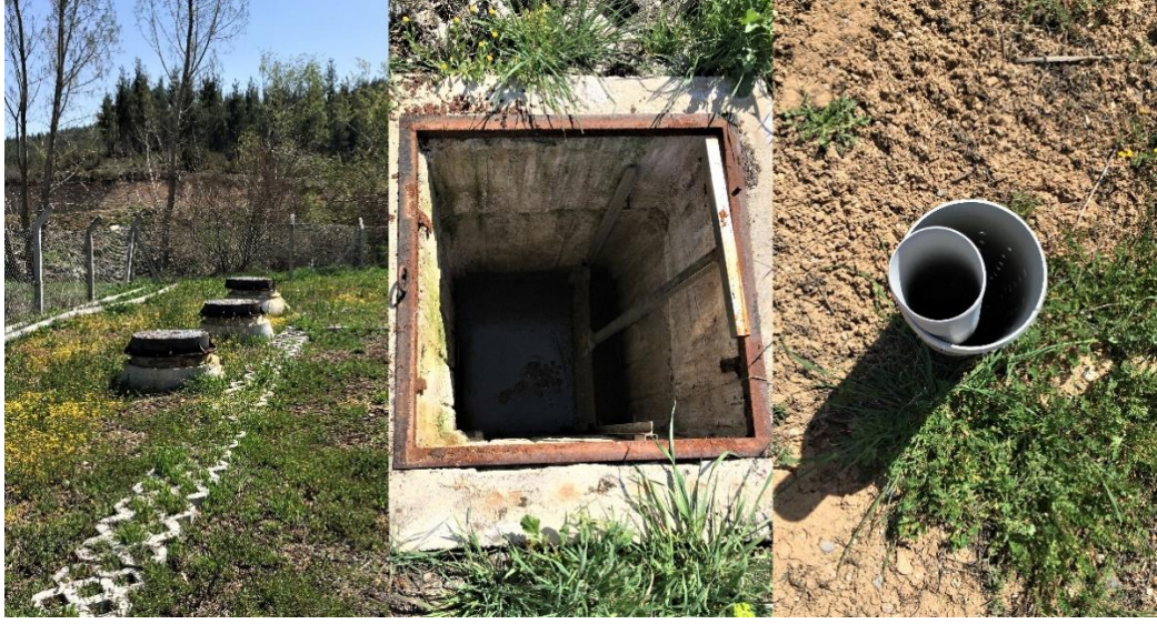
Şekil 4.4: Alikurt Doğal Atıksu Arıtma Tesisi giriş yapısı ve giriş atıksuyu numunesi toplama istasyonu
