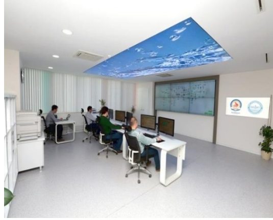
Şekil 4.1: SCADA izleme odası.
