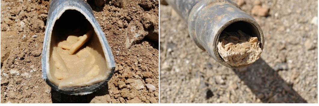
Şekil 5.8: İçme suyu iletim borularında meydana gelen kabuklaşma.
