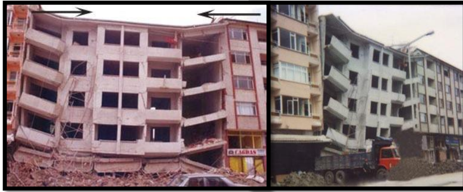
Şekil 3.13: Çekişleme Etkisi ile Hasar Gören Yapılar (Halit Coza Arşivi)
