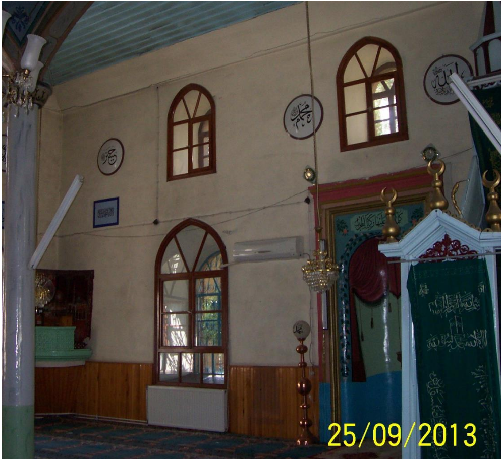
Fotoğraf 176: Havai Camii, 2014 Yılı Restorasyon Öncesi Güney Duvarı (V.G.M Arşivi)
