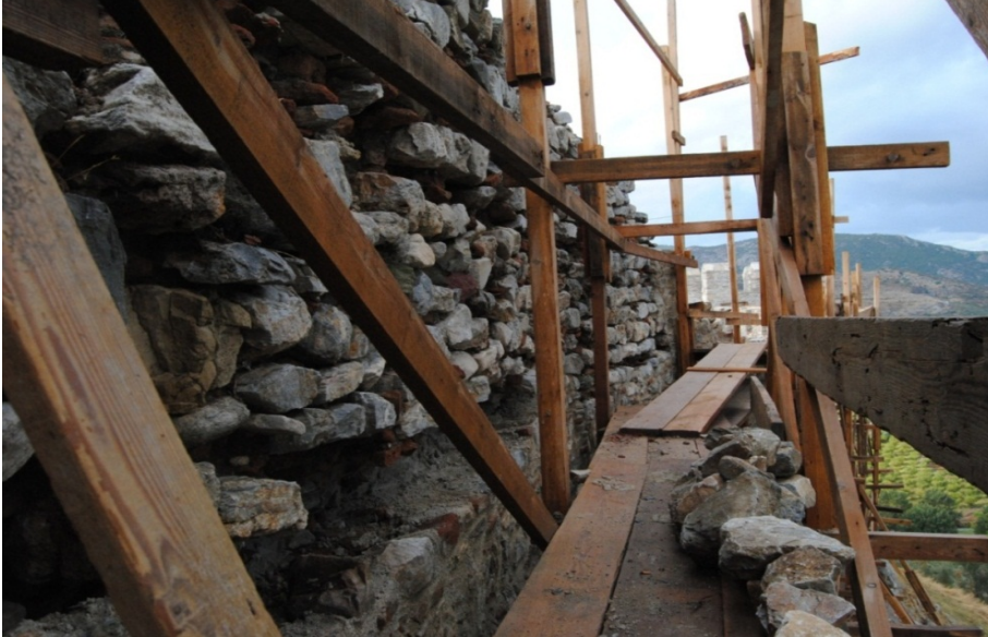
Resim 139: BK 4 – BK 5 arasındaki sur duvarları dış yüzü derzleme ve onarım öncesi.
