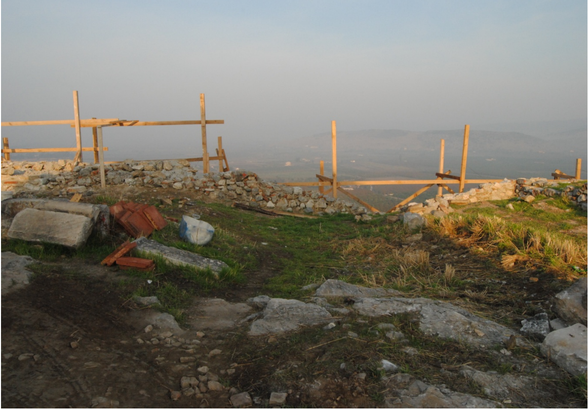
Resim 142: BK 4 – BK 5 arasındaki sur duvarları (Kuzey bölüm) iç yüzü onarımdan önce.
