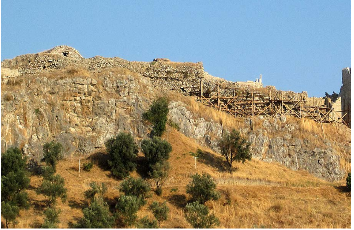
Resim 135: BK 3 – BK 5 Kuleleri arasındaki beden duvarı onarım öncesi.
