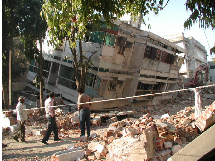
Şekil 2. İlk katı yumuşak kat nedeniyle göçmüş bir bina (Goel, 2003)
