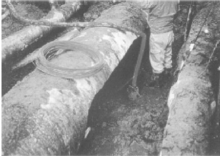
(b) 0.8 m çaplı font boru hasarı
