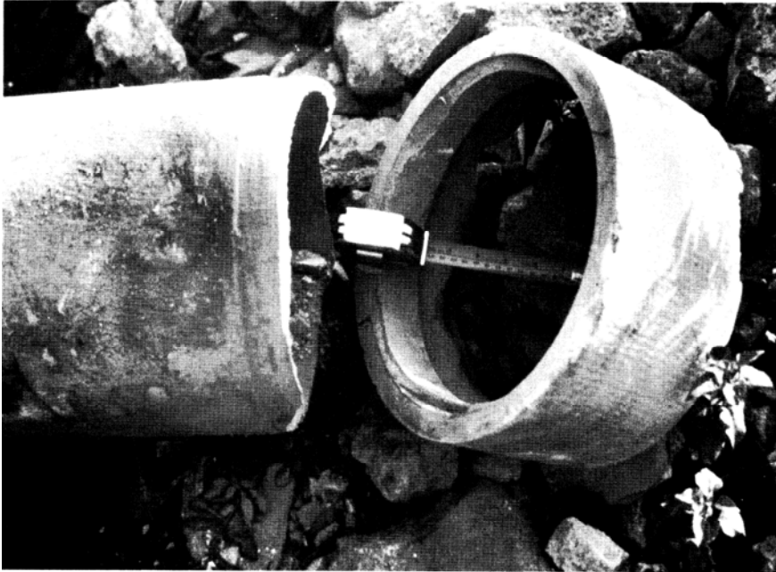
(b) 1985 Michoacan Meksika depreminde asbest boruda bağlantı noktasında meydana gelen kırılma (Ayala ve O'Rourke 1989)
