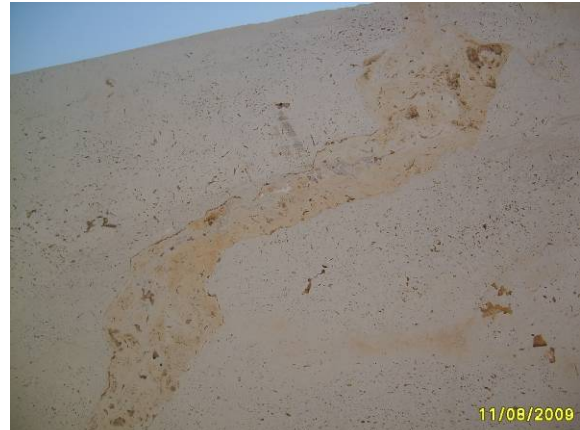
d- Çatlak arasının kil dolgu ile dolduğu yapı.
