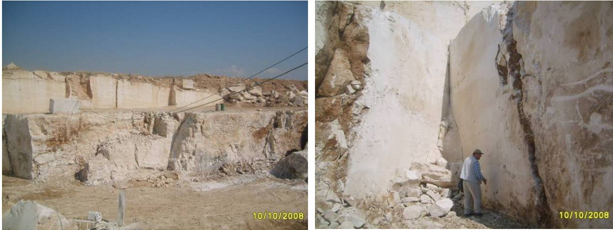
Şekil 22. Sorkun Mermer firmasına ait 4 nolu ocakta yaygın kırık ve çatlaklılıktan görünüm.
