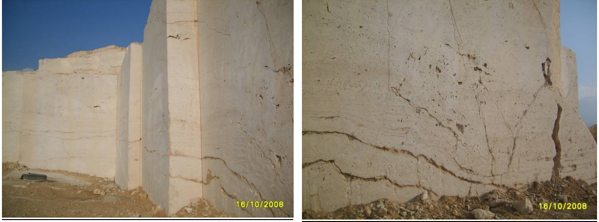
Şekil 50. Tetik Mermer firmasına ait terkedilmiş ocağın ve aynalarda görülen yatay çatlaklılıkların genel görünümü.
