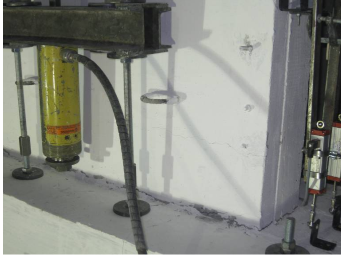
Şekil 7.15 C3BB elemanında perde tabanında eğilme çatlakları
