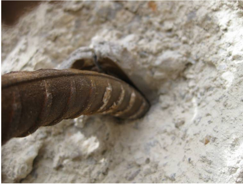
Şekil 3.5 Paslı donatı ile ekilen ankrajda epoksi ile donatının yapışmaması
