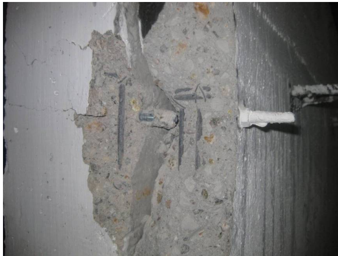
Şekil 7.20 C3DD elemanında kolon ankrajının kopması
