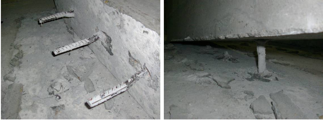
Şekil 5.4 Deney sırasında oluşan hasarlar
