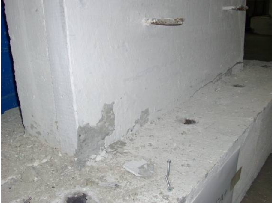
Şekil 7.6 Ankraj oranı yüksek C2 elemanlarda görülen perde eğilme çatlakları
