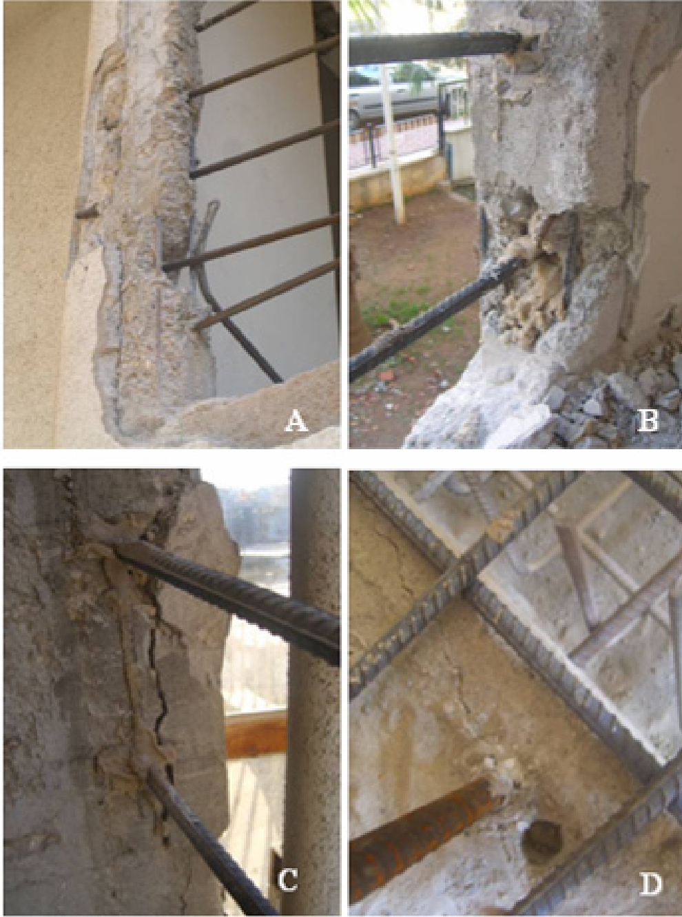
Şekil 3.2 Kötü yapılmış ankraj örnekleri (A,B: Bozuk yüzeylere yapılmış ankrajlar; C: Çatlağa yakın yapılmış ankraj; D: Çekme deneyinde betonu çatlatan ankraj ( \Phi 26 ))
