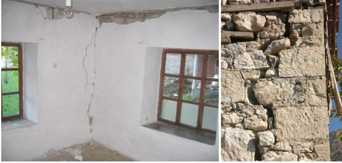
Şekil 5.9. Duvarların birleşim bölgelerinde yetersiz kenetlenmeden dolayı oluşan ayrılma hasarı
