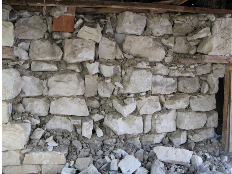
Şekil 5.6. İç ve dış duvar tabakaları arasında bağlantı yapılmaması
