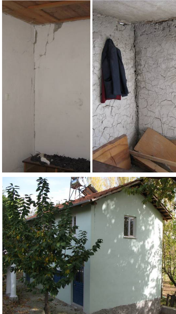
Şekil 5.10. Köşe birleşimlerinde hasarlar
