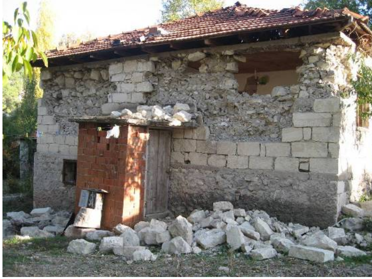
Şekil 5.5. Ağır hasarlı yığma yapı
