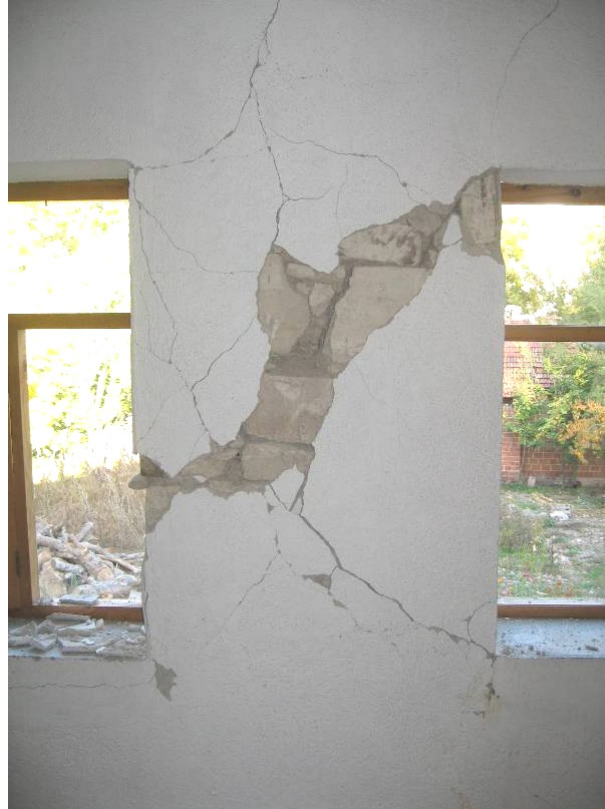
Şekil 5.11. İki pencere boşluğu arasında kesme hasarı
