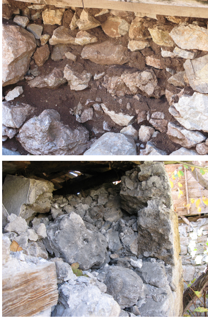
Şekil 5.3. Göçen bazı duvarlardaki duvar malzemesinin uygun olmayan şekli
