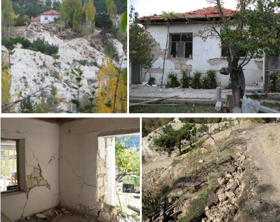
Şekil 5.1. Tepe-yamaç etkisi ile oluşan hasarlar
