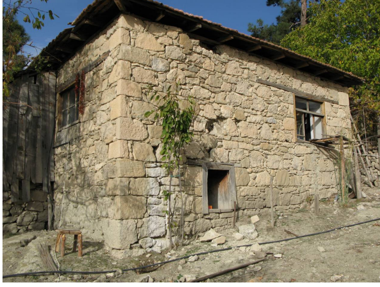
Şekil 5.12. Duvar üstünde düzlem dışı hasar
