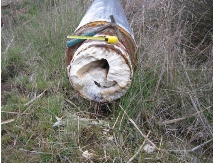
Şekil 4.11. Jeotermal su iletim borusunda gzlenen kabuklaşma
