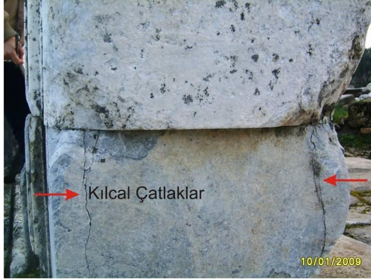
Şekil 8. Lagina Hekate Kutsal Alanı Propylon ve giriş kapısında sütun altı malzemesi olarak kullanılan mavimsi-gri renkli kireçtaşı bloğu ve yük etkisiyle blokta meydana gelmiş kılcal çatlaklar (üstteki blok 76*53*460 cm boyutlarında olup yaklaşık ağırlığı 4.6 tondur).
