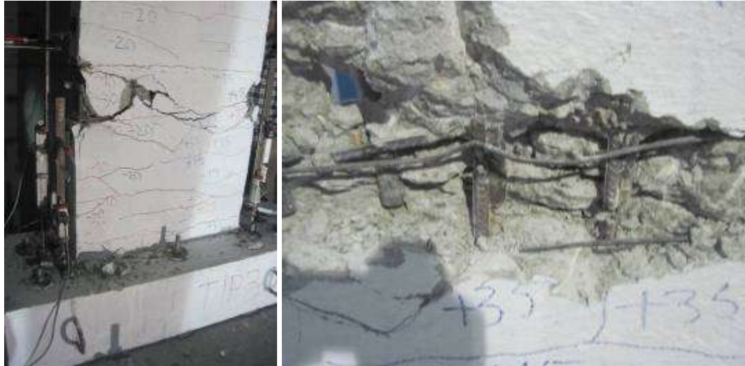
Şekil 4.25. Perdede dağılan beton ve kopan boyuna donatı.
