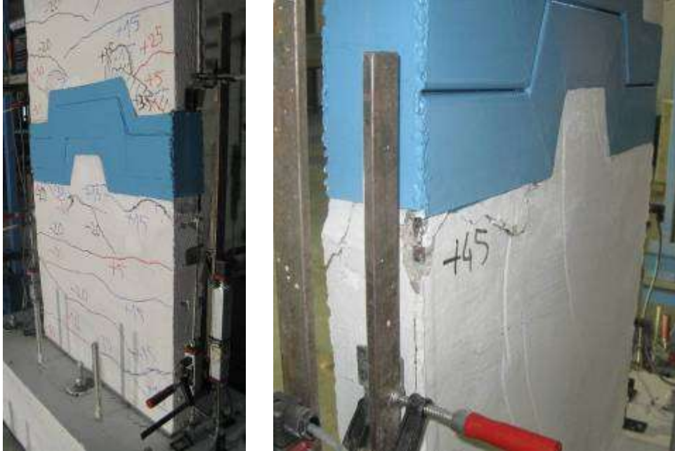
Şekil 4.8. +45 mm tepe deplasmanında perdede oluşan eğilme çatlakları.
