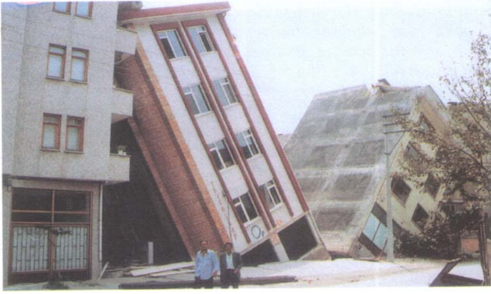
Şekil 3. 1999 Kocaeli (İzmit) depreminde Adapazarı'nda eğilme formunda aşırı temel deformasyonuna maruz kalmış binalar (Sucuoğlu vd 2000)
