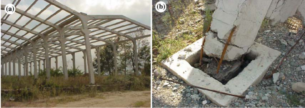
Şekil 5.3. Prefabrik yapılarda meydana gelen deprem hasarları
