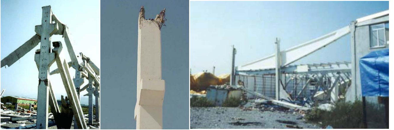
Şekil 5.7. Makas devrilmesi ile oluşan birleşim hasarlarından örnekler
