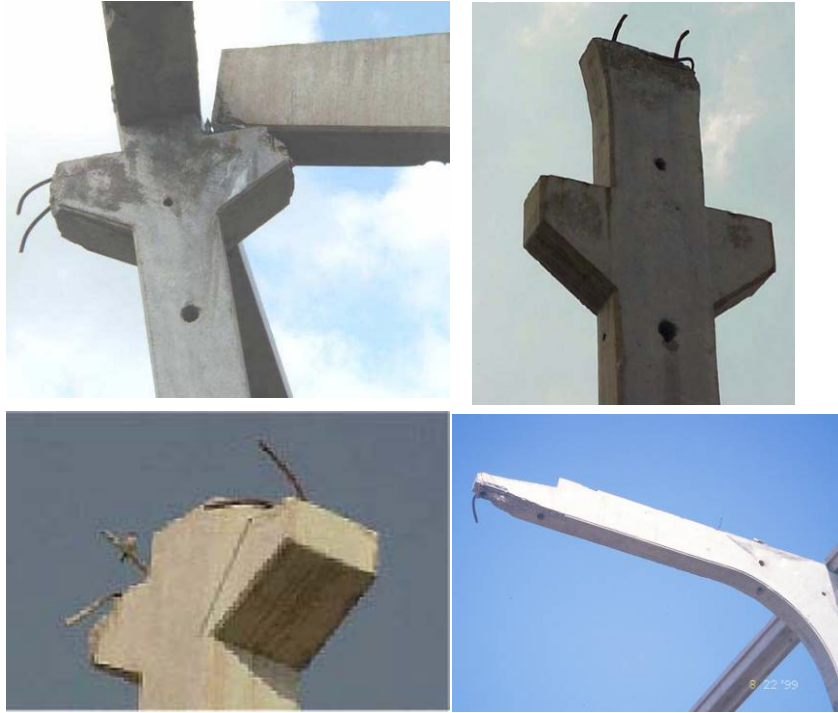
Şekil 5.5. Geçmiş depremlerden sonra tespit edilen birleşim bölgesi hasarları
