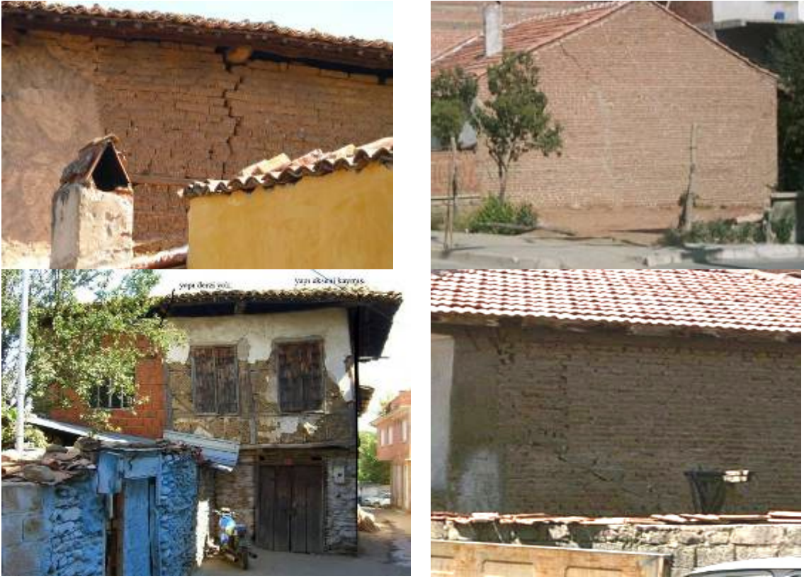
Şekil 4.24 Yığma yapı hasarlarına örnekler
