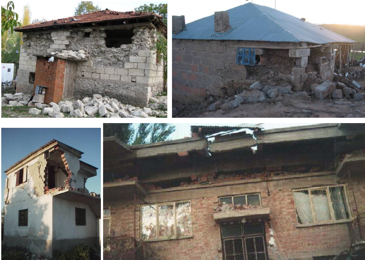
Şekil 1.1 Ülkemizde son yıllardaki depremlerde hasar gören yığma yapılardan örnekler
