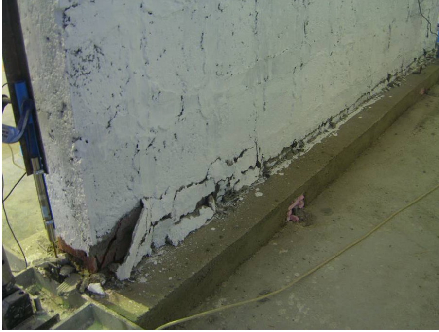
Şekil 6.32. Basınç ezilmesi ve diyagonal çatlaklar
