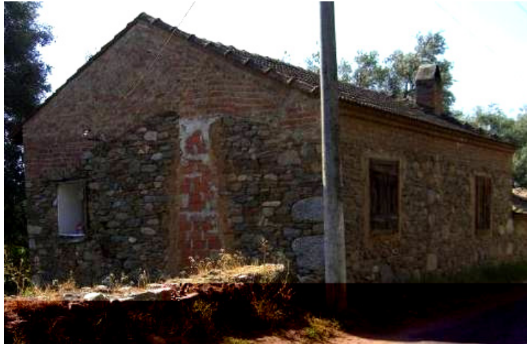
Şekil 4.12 Yığma yapıda çok farklı malzemelerin kullanılması durumu
