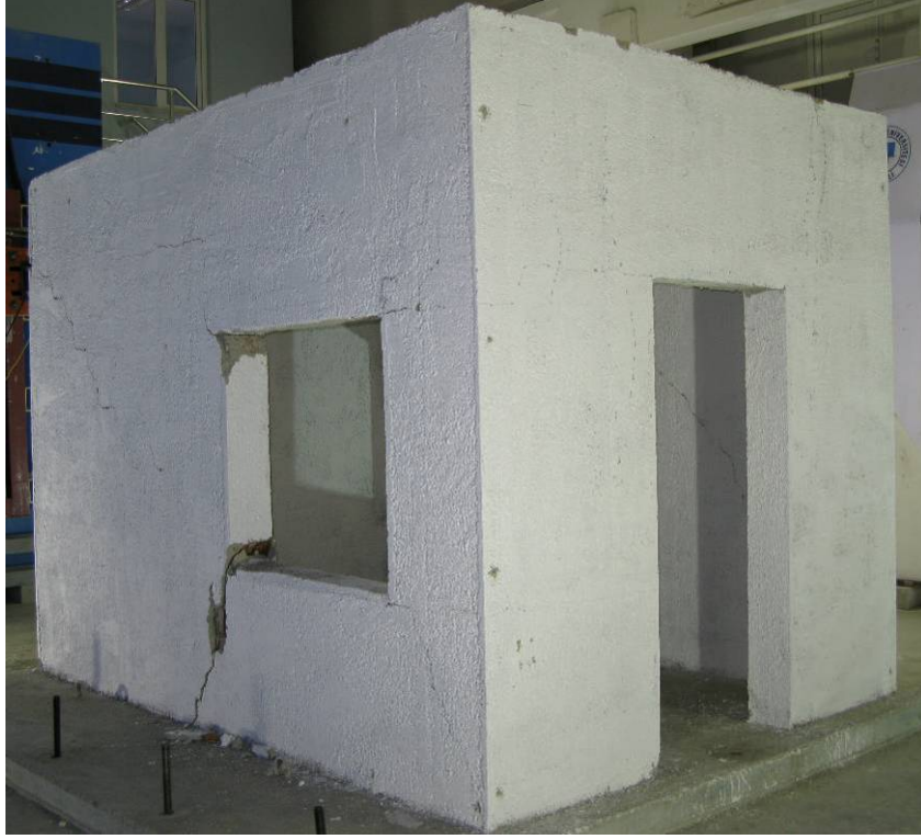
Şekil 6.103 Deney sonunda ortaya çıkan hasarlar
