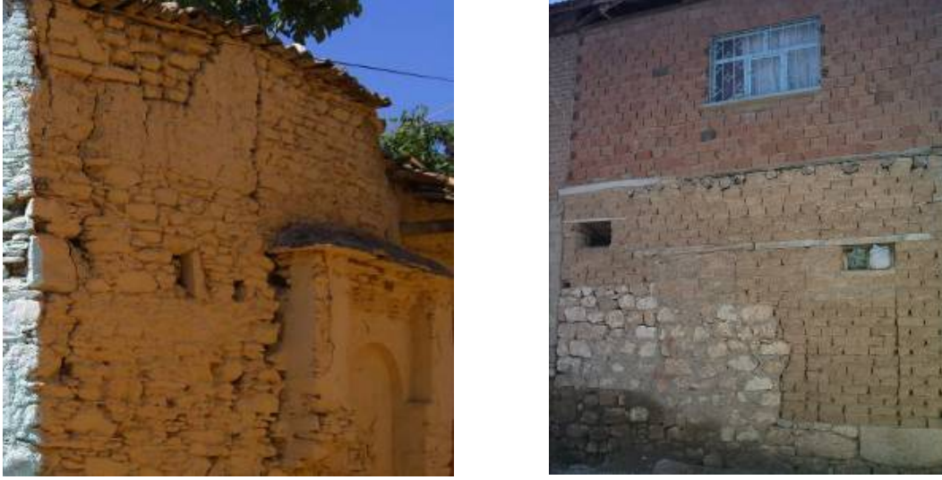
Şekil 4.13 Uygun malzeme ve bağlayıcı harç kullanılmaması sonucu oluşan hasar
