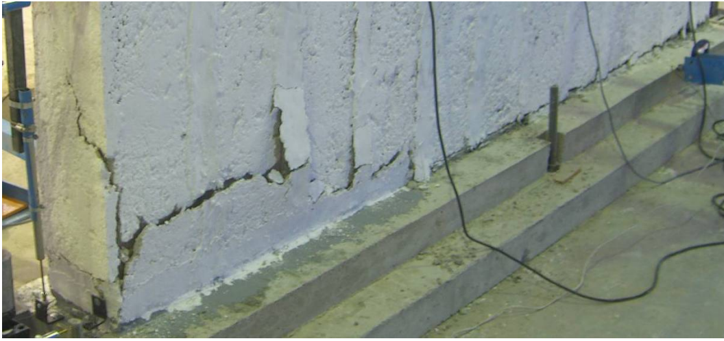
Şekil 6.26. Çatlak kapanması sonrası basınç altında sıva dökülmesi
