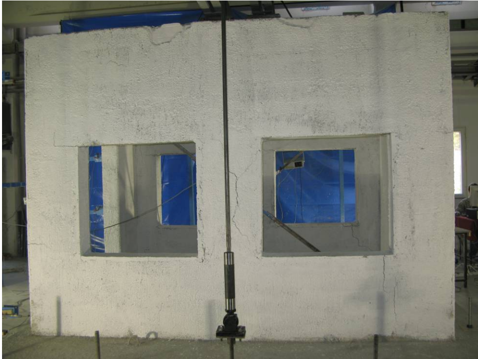
Şekil 6.106. İlk çatlak oluşumları
