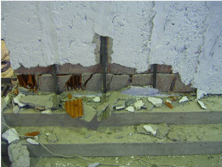
Şekil 6.27. Duvar köşesinde diyagonal çatlaklar
