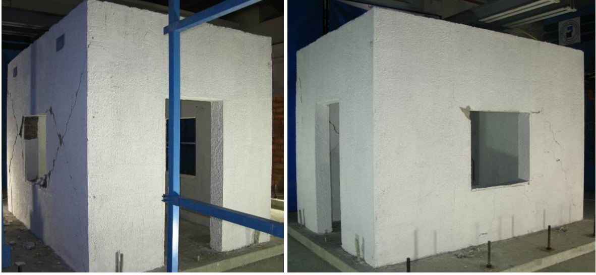
Şekil 6.83 Onarılmak üzere hasar verilen yapının (YB4A) deney sonu görünümü
