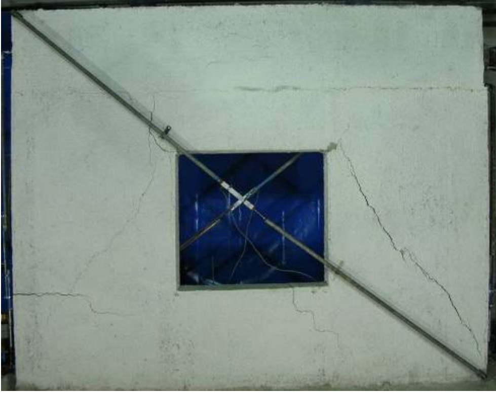
Şekil 6.49. Ardışık çevrimlerde oluşan çatlaklar
