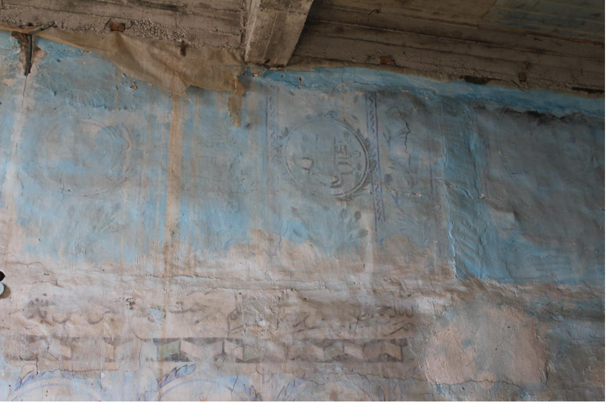
Fotoğraf 19: Künar Köyü Camii, batı duvarı üst seviye ortadaki panolar
