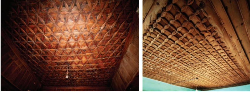
Fotoğraf 37: Güneydoğu oda tavanı Fotoğraf 38: Güneybatı oda tavanı
