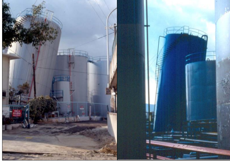
Resim 2.7: Tankta farklı oturmalar nedeniyle tankın yana yatması ( https://research.engineering.ucdavis.edu/gpa )
