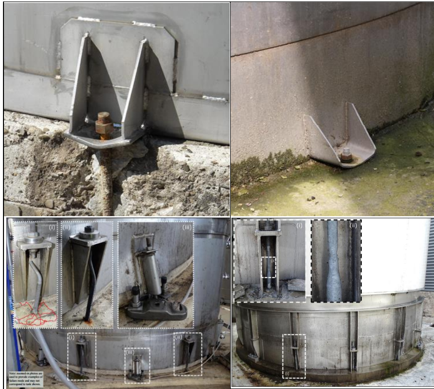
Resim 2.6: Tankta ankraj bulonunun betondan ayrılması, ankraj plakasının eğilmesi, ankrajın kopması (Brunesi ve diğ. 2015), (Dizhur ve diğ. 2017).
