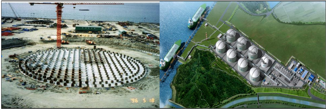
Resim 2.14: Güney Kore Incheon 100,000 m 3 hacimli LNG Tankları 392 HDRB kullanılmıştır. 3 s dinamik periyod. D:70 m, H:36 m. (Dr. Yang 2011).
